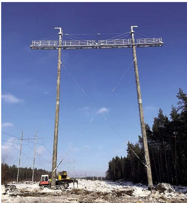
Рис. 11 – Портальная железобетонная опора 2СПБ500-3В на ВЛ 500 кВ «Донская АЭС – Старый Оскол 2»
